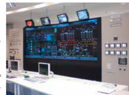
四国計測工業が手掛けた坂出發電所の中央監視操作システム。プラントの運転状態が大型スクリーンに表示されている。
