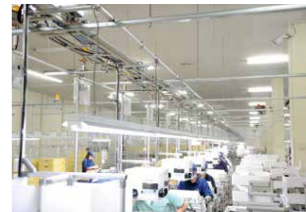
作業台用の照明などを固定する梁もGF製。ストレートコネクタを使ってフレームをつなぎ、さまざまなアイテムを取り付けている。
