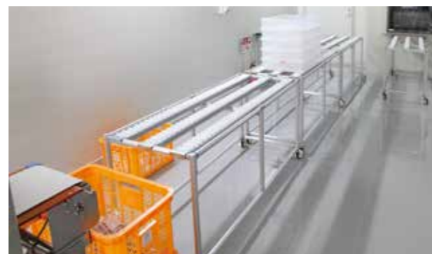
収穫し、梱包されたレタスを流すためのGF製シューター。栽培室の隣には保存用の大型保冷庫があり、収穫したレタスをそのまま流せるつくりになっている。
