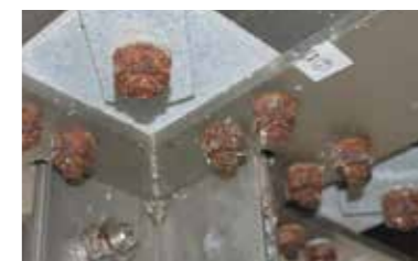
赤さびが発生したアルミ以外の金属部材
