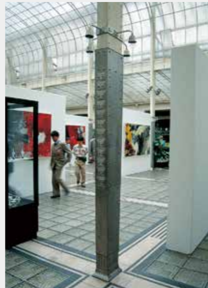
鉄骨支柱のカバー。
