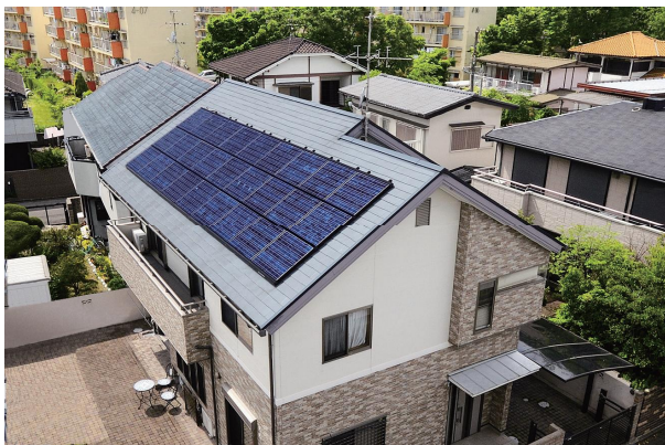
太陽光発電パネル（シャープ（株）提供）
